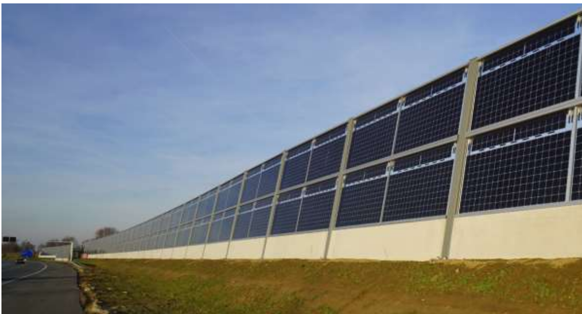
Modulair geluidscherm met geïntegreerde PV-installatie langs de A50
