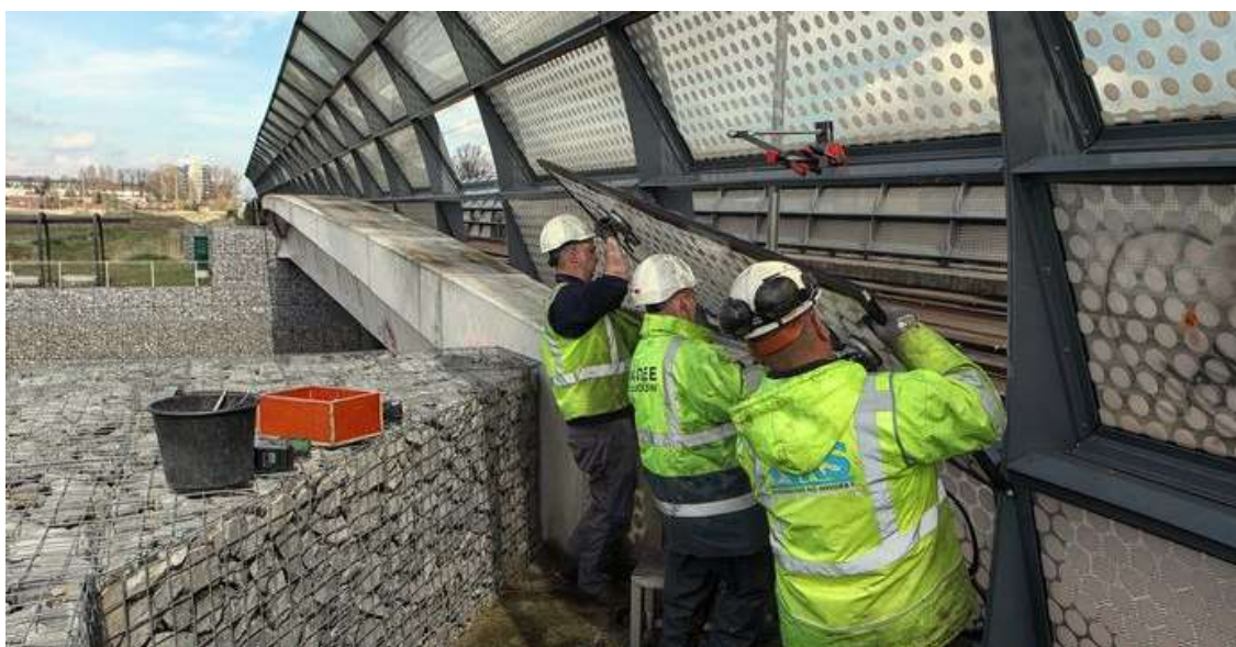
Geluidschermen met zonnepanelen langs spoor Roosendaal
