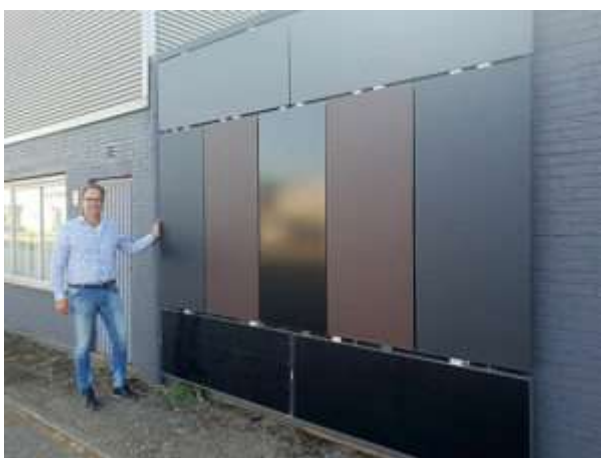
Zonnepanelen op gevels
