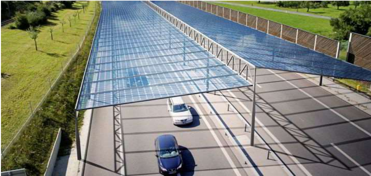
Zonnepanelen op de ringwegen rond Groningen
